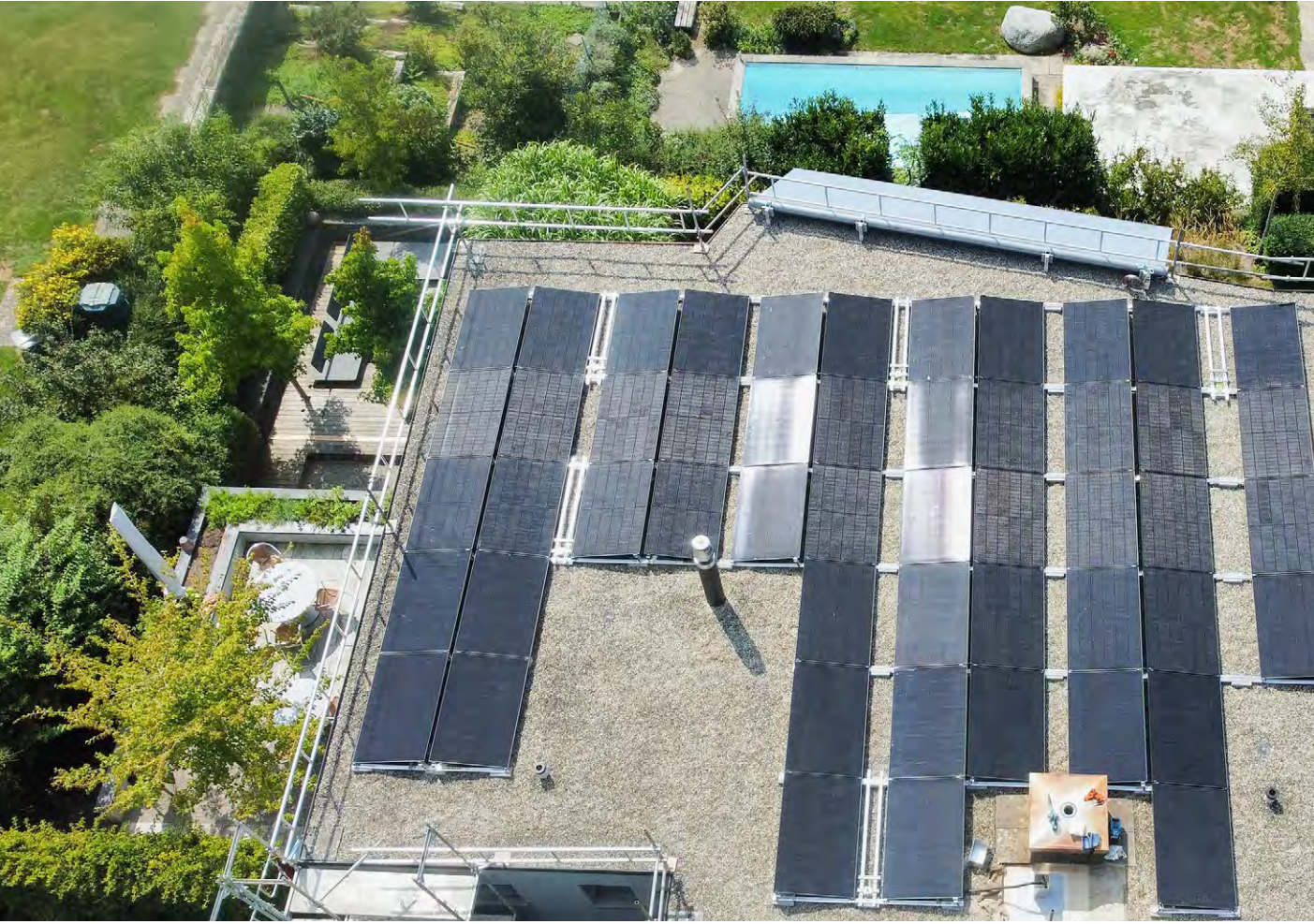
Sektorkoppelung – die Solaranlage kombiniert mit Speicher deckt 50 Prozent des Eigenbedarfs im Winter und speist das Elektrofahrzeug.
